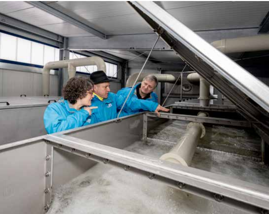
v.l.n.r.: Ina Hovy und LWG-Geschäftsführer Marten Eger mit Karsten Horn, Projektleiter Strukturwandel beim Wasserversorger, an einer neuen Anlage zur physikalischen Restentsäuerung im Wasserwerk Cottbus-Sachsendorf. Foto: Johannes Zantow
