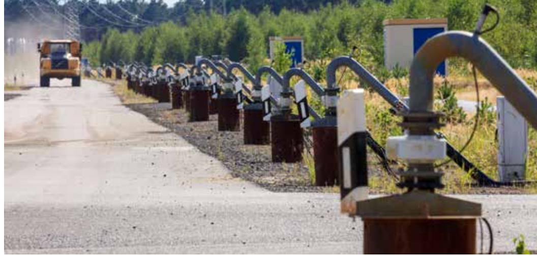
Noch werden durch die LEAG jährlich etwa bis zu 300 Mio. m 3 Sumpfungswasser gehoben – mit Hilfe solcher Entwässerungsbrunnen. Foto: LEAG/Rainer Weisflog
