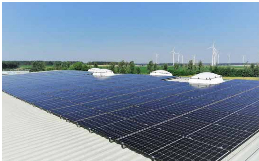
EMIS plant und realisiert PV-Anlagen auf Freiflächen und auf Dächern – so wie hier bei LKT in Luckau.
