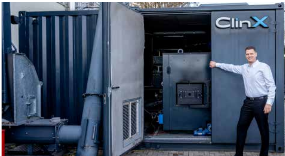
Visionär Sebastian Kießling ist sichtlich stolz auf sein klimapositives Anlagensystem.
