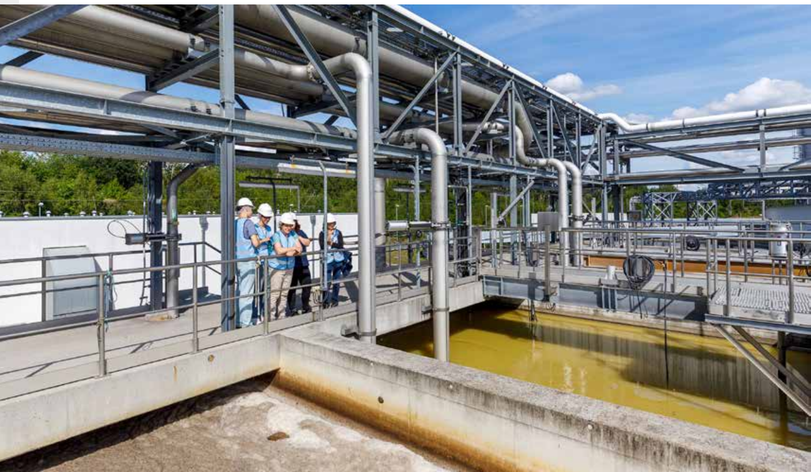
Die moderne Abwasserbehandlungsanlage, betrieben vom Team der ASG Spremberg GmbH, war einer der Besucherfavoriten. (Fotos: A. Franke)
